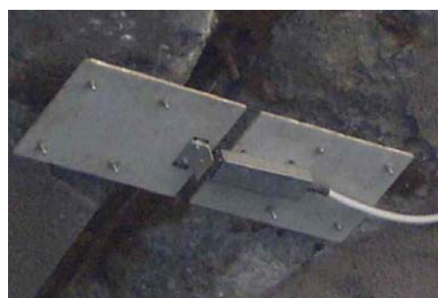
Рис.3. Датчик перемещения, смонтированный на Москворецком мосту
